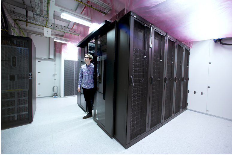
Figure 1.2: The SICS datacenter, Luleå (courtesy of Pär Bäckström).
